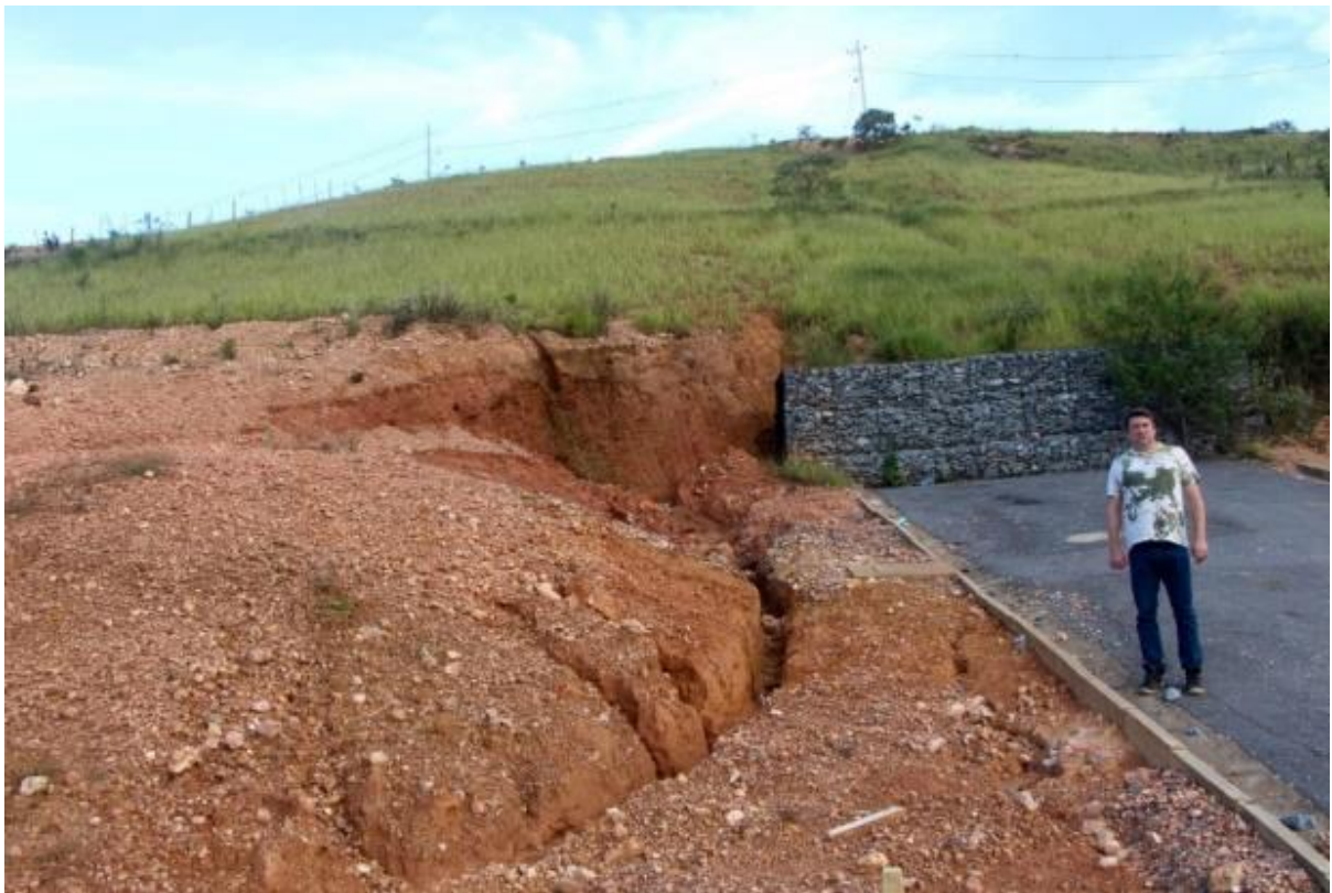
Figura 11 – Barreiras para contenção do movimento de massa – acervo do autor- ano de 2015.
